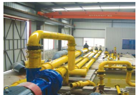
▲ 喷嘴测试泵站
